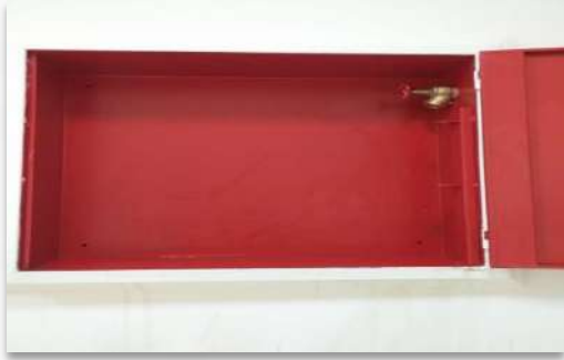
تأهيل صناديق الحريق
